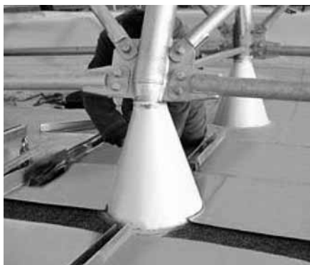
Фото 4: Область кровли с большим количеством проёмов
